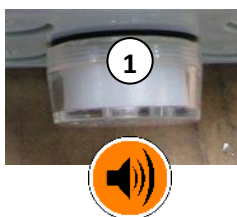
Abb. 10: Akustikmelder am Steuerschrank
